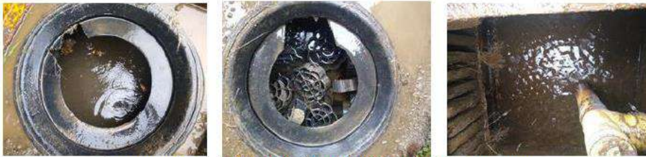
Imagen 40. TS – FAFA – Caja de salida FFP de la PTAR Sawerman
