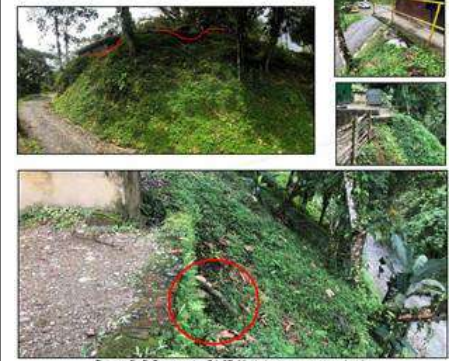
Fotografía 7. Foco erosivo BA-07. Movimiento en masa rotacional. Fuente: Geoservicios, 2020.
