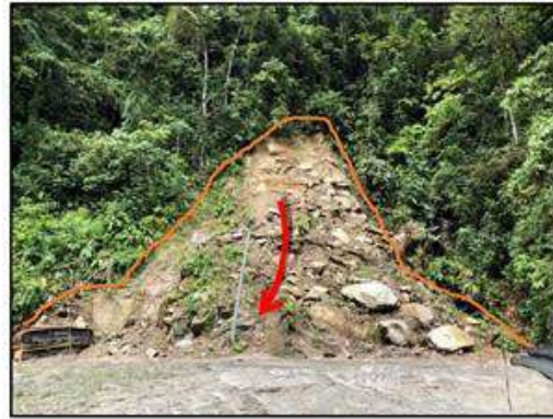
Fotografía 3. Foco erosivo BA-03. Movimiento en masa rotacional. Fuente: Geoservicios, 2020.
