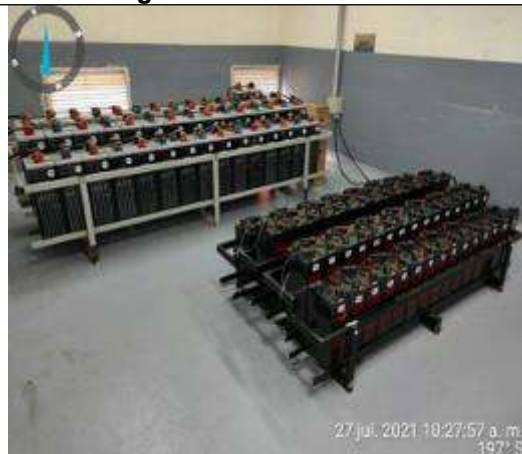
Fotografía 52 Banco de baterías
