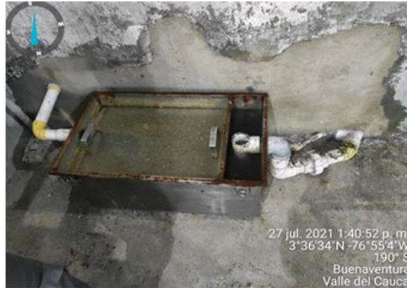
Fotografía 17 Trampa de grasa
