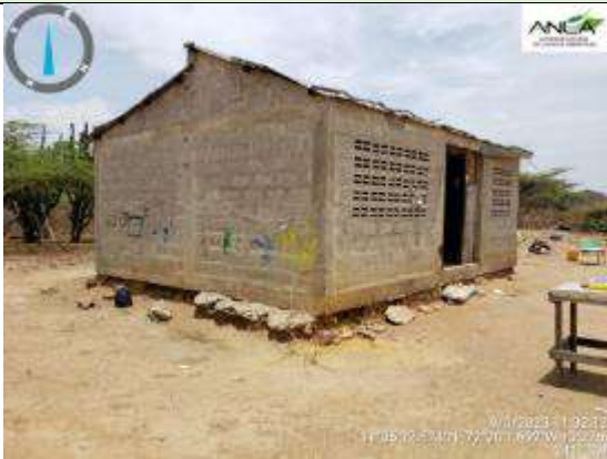
Fotografía 68. Estado de la vivienda cercana a la vía – cauce Coordenadas Magna Sirgas, origen Único E: 5072601 - N: 2839101
