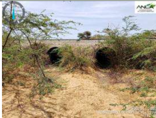
Fotografía 56. Panorama descole alcantarilla de la línea férrea en el K65+190 Coordenadas Magna Sirgas, origen Único E: 5073288 - N: 2839145
