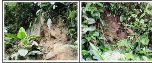
Fotografía 14. Foco erosivo BA-12. Movimiento en masa de tipo caída de rocas. Fuente: Geoservicios, 2022.
