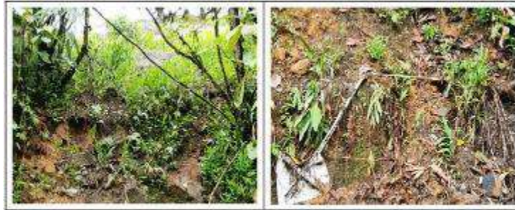
Fotografía 17. Foco erosivo BA-15. Movimiento en masa. Fuente: Geoservicios, 2020.
