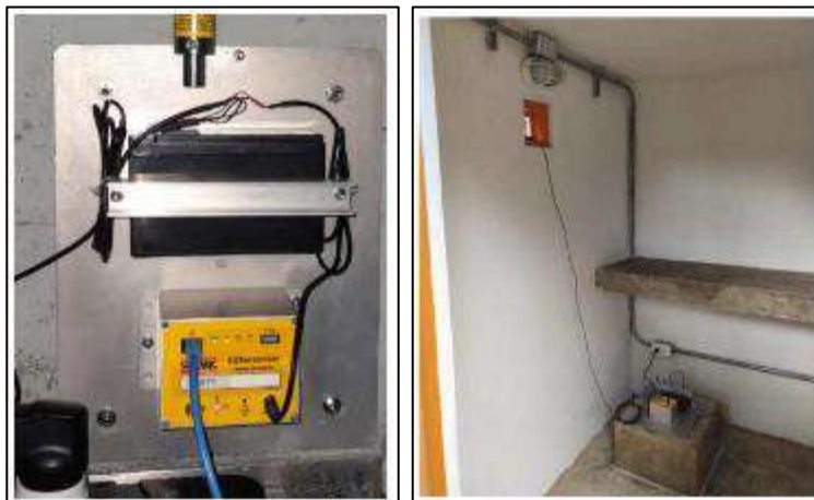
Figura 97. Registro fotográfico de acelerógrafos (Izquierda-Galería 1; Derecha-estribo derecho, caseta de instrumentación)
