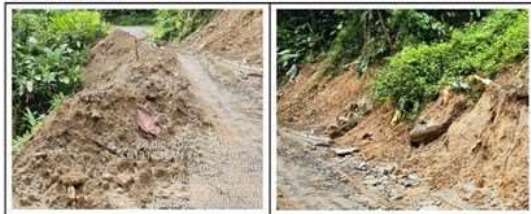
Fotografía 13. Foco erosivo BA-11. Movimiento en masa rotacional. Fuente: Geoservicios, 2022.
