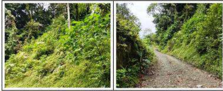
Fotografía 11. Foco erosivo BA-09. Movimiento en masa de tipo calda de rocas. Fuente: Geoservicios, 2022.
