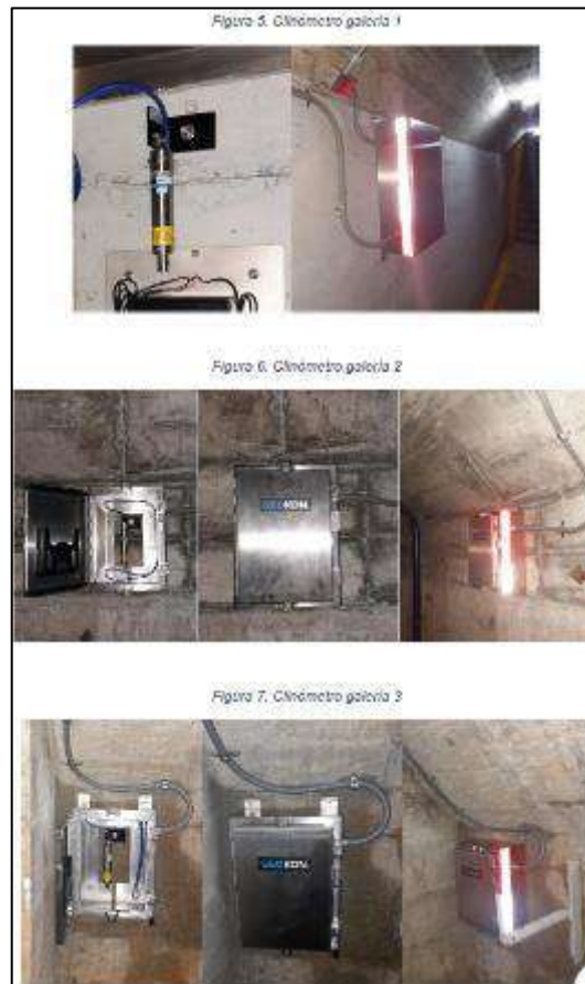
Figura 98. Registro fotográfico de clinómetros
