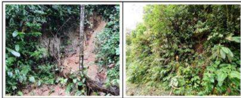
Fotografía 4. Foco erosivo BA-02. Movimiento en masa traslacional. Fuente: Geoservicios. 2022.
