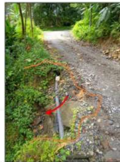
Fotografía 11. Foco erosivo BA-11. Movimiento en masa rotacional. Fuente: Geoservicios, 2021.
