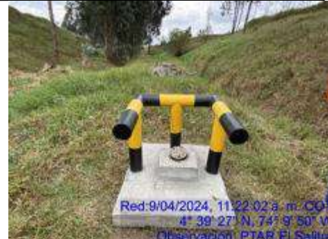
Fotografía 80. Estado actual del piezómetro 2- predio la Magdalena
