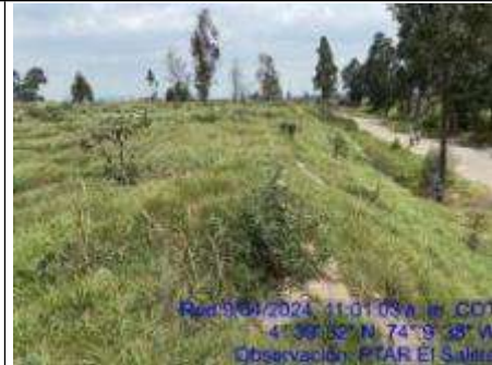
Fotografía 26. Estado actual de los taludes y de la superficie de la celda 11 del predio la Magdalena
