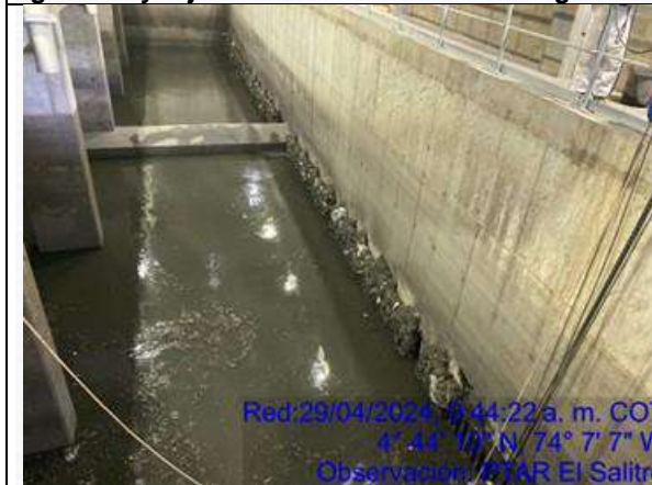
Fotografía 67. Zona de retención de sólidos muy gruesos y rejillas de retención de sólidos gruesos
