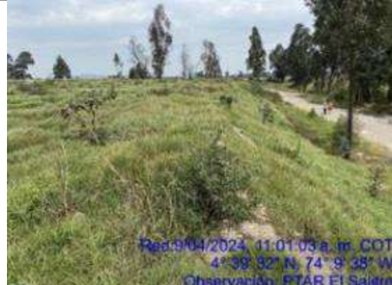
Fotografía 2. Estado actual de los taludes y superficie de la celda 11 del predio la Magdalena
