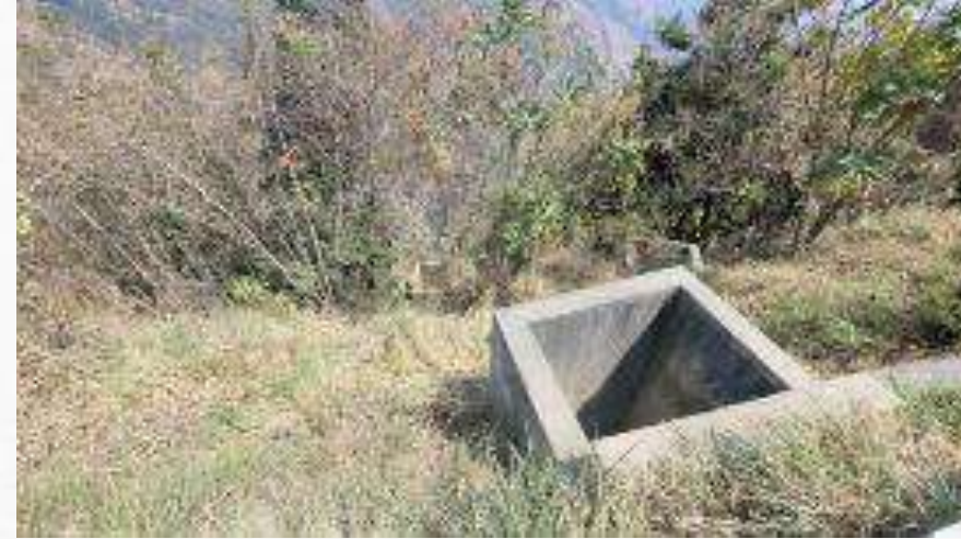
Manejo de agua en sitio erosionado
