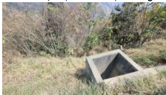
Fotografía 34. Manejo de agua en sitio erosionado Coordenadas: E 4679602,525; N 2300280,362 Origen Único Nacional
