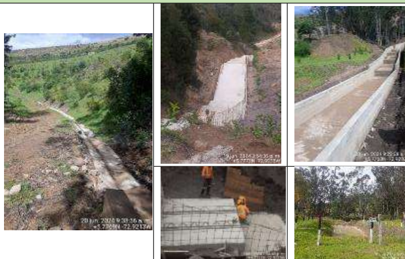
Fotografía 14. Sistema de drenaje ZODME Nobsa Coordenadas Origen Único Nacional (E: -72.9213 - N: +5.7769)
