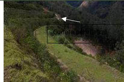
Fotografía 13. Sistema de drenaje, zanjas de pie de talud y perimetral
