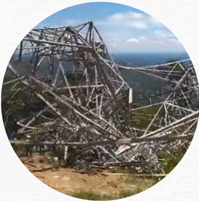
Fuente: Pérdida de Verticalidad de Torre Eléctrica en San Vicente de Chucurí Julio 2024.
