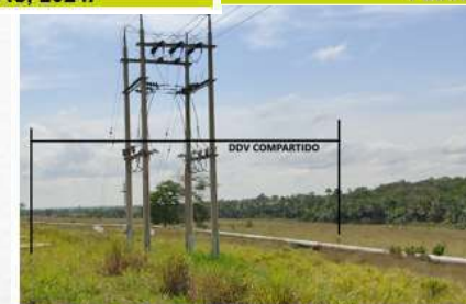
Fotografía 2-30 Derecho de vía compartido (Línea de flujo+ Línea eléctrica) Fuente: SGI S.A.S, 2024.
