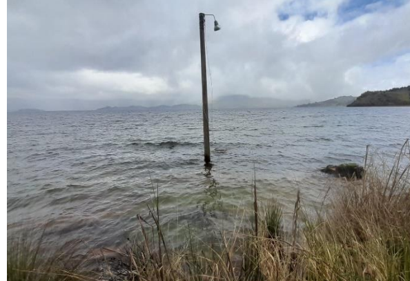
Fotografía 10. Poste de energía
