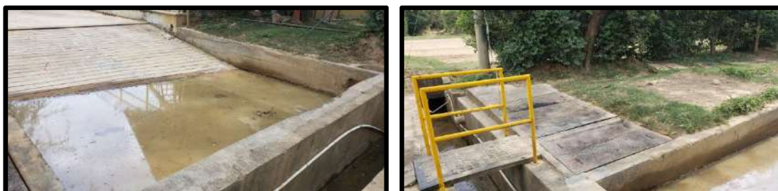
Fotos 5 y 6. Sedimentador y trampa de grasas.
