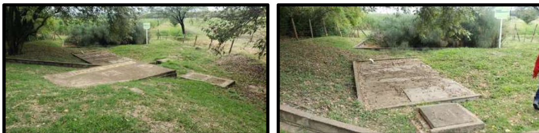
Foto 1 y 2. Aspecto general Tanque séptico y FAFA.
