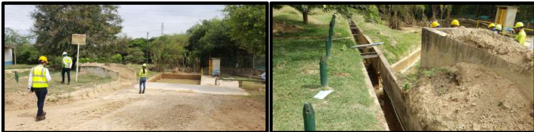
Fotos 8 y 9. Sedimentador y compuerta bypass sistema de bombeo y recirculación molienda.
