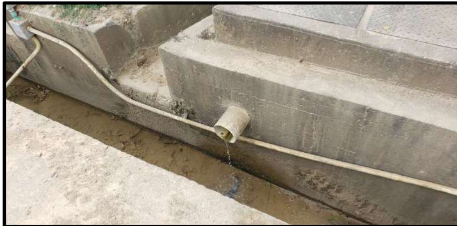
Foto 7. Punto vertimiento aguas residual no doméstica.
