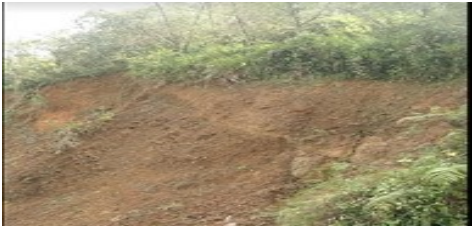
Fotografía 9. Deslizamiento recurrente en la vía Simón Bolívar - vereda Cabas Km 57+200
