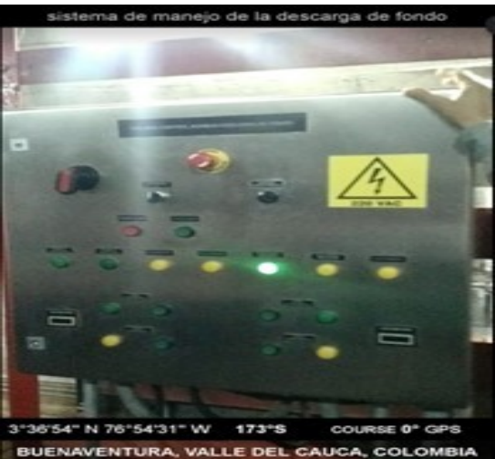
Fotografía 22. Controles de la descarga de fondo
