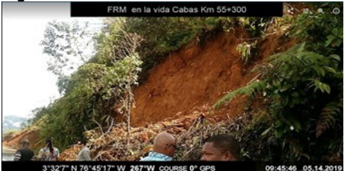
Fotografía 8. Deslizamiento de suelo residual rojizo en la antigua vía al mar – Simón Bolívar - vereda Cabas Km 55+300, se resalta que este material no llega al río Digua
