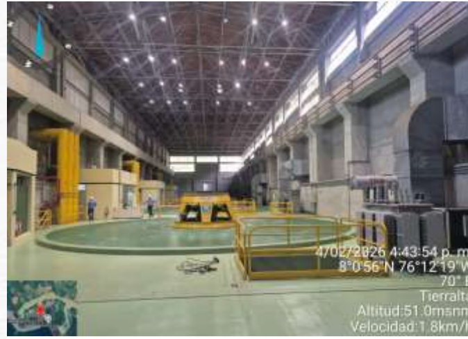
CASA DE MÁQUINAS
