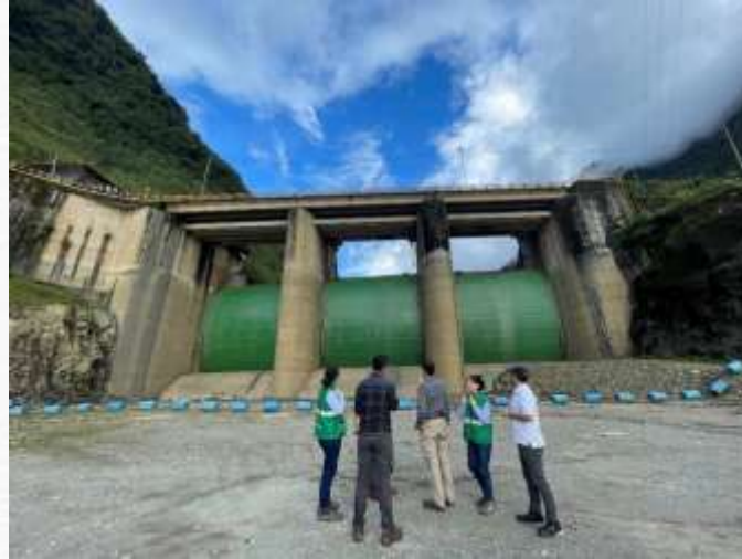
COMPUERTAS REBOSADERO DEL EMBALSE
