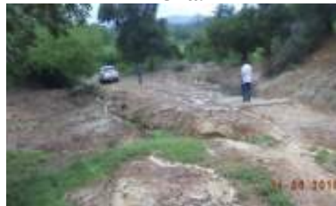
Fotografía 35 Erosión laminar y cárcavamiento en la vía de acceso del proyecto – E:1090356, N: 1559002 MSBta
