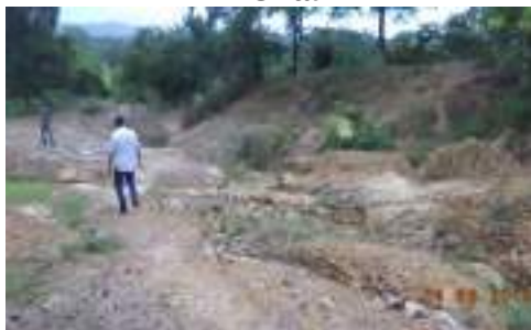
Fotografía 34 Erosión laminar y cárcavamiento en la vía de acceso del proyecto – E:1090356, N: 1559002 MSBta
