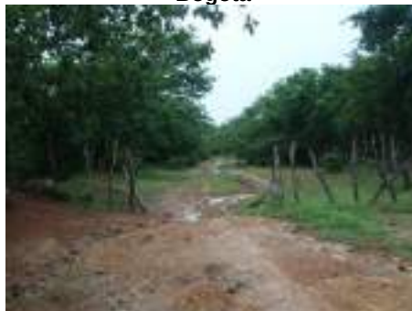
Fotografía 8 Cárcavas en la vía en alta pendiente. E: 1090357, N: 1558990 Origen Bogotá
