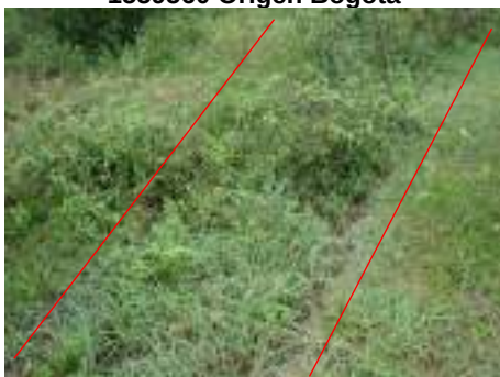
Fotografía 3 Cuneta obstruida con vegetación y sedimentos. E: 1090348, N: 1559560 Origen Bogotá
