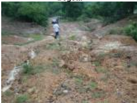
Fotografía 7 Cárcavas en la vía en alta pendiente. E: 1090357, N: 1558990 Origen Bogotá
