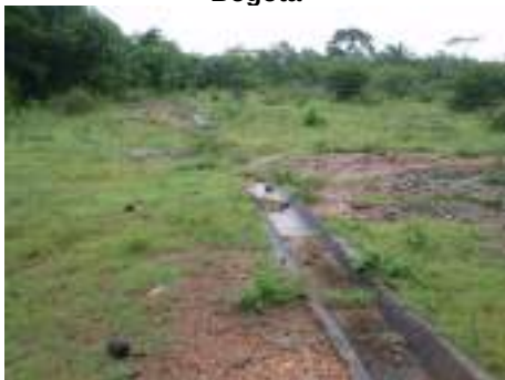
Fotografía 13 Cunetas de aguas lluvias obstruidas. E: 1090455, N: 1559462 Origen Bogotá
