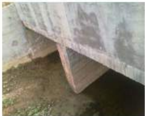
Foto 75. Box para paso de la quebrada
