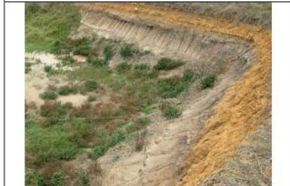
Fotografía 23 Taludes en las paredes de la laguna de homogenización de lixiviados. Se observa falta de cubrimiento. Coordenadas Magna Sirgas Origen Bogotá E: 976877 - N: 1006024
