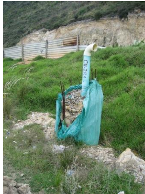
Foto 16. Chimenea para evacuar gases construida de una manera poco técnica.
