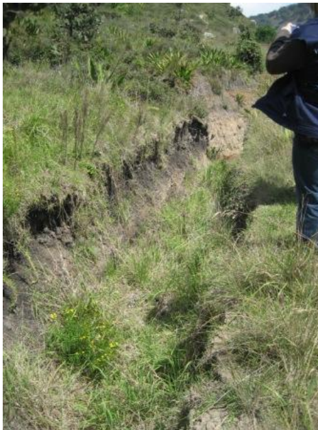
Foto 15. Canal para recolección de aguas lluvias sin recubrimiento y sin mantenimiento
