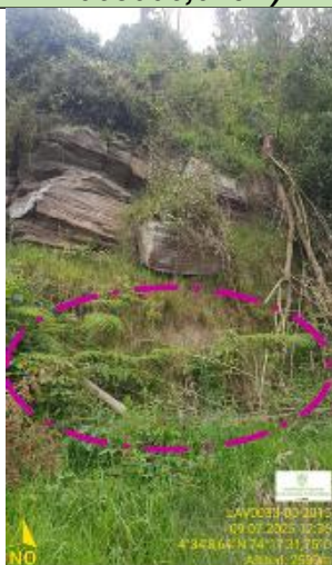
Fotografía G30 escarpe de falla en área adyacente a sitio de torre 305. (Coordenadas planas origen único 4856720E 2063006,049N)
