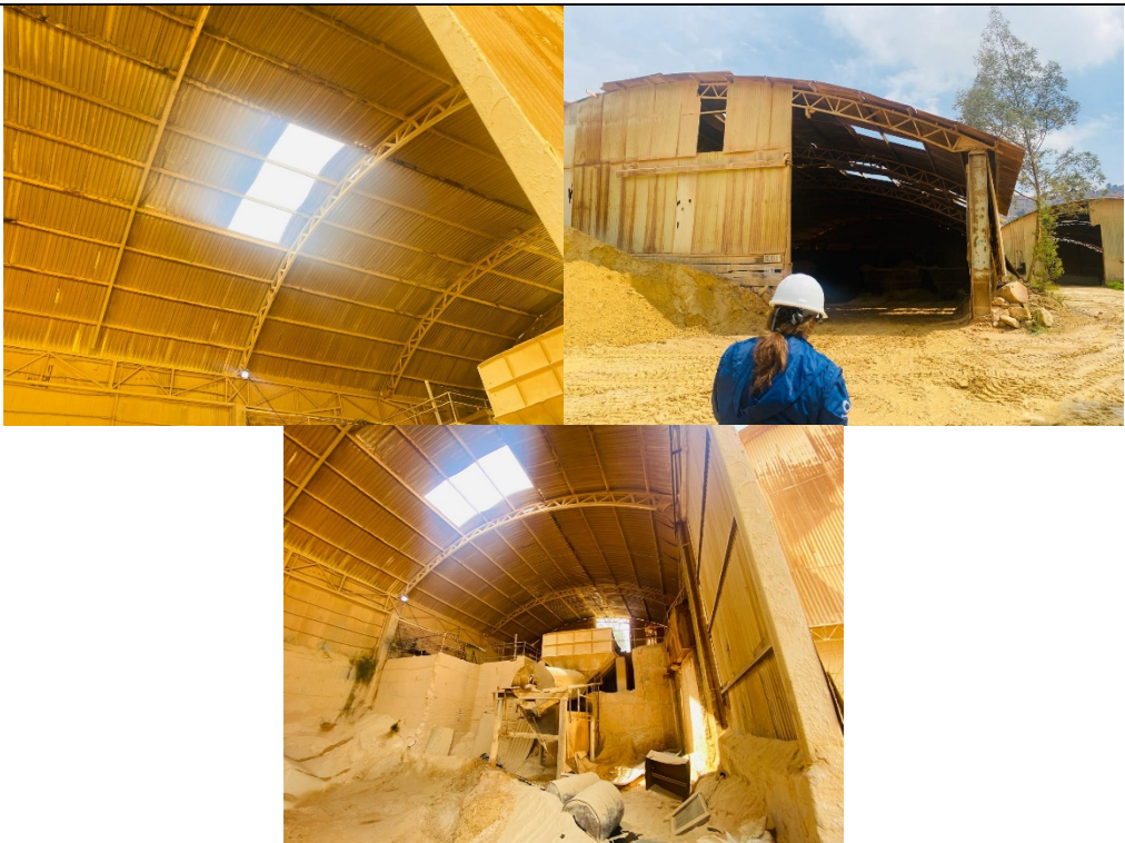
Fotografías 9-11. Techos en malas condiciones
