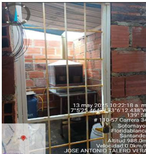
Ubicación del Horno accionado con gas natural tipo pipeta como combustible, sin las más mínimas normas de control del manejo de los gases y vapores generados durante el proceso de fundición, para que con buenas prácticas de ingeniería contrarrestar las presuntas emisiones fugitivas del material particulado, por ende, acatar lo
