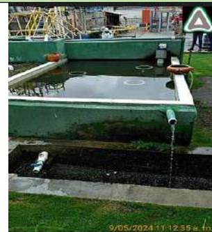
Fotografía 2. PTARD – Lodos activados
