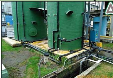
Fotografía 1. PTARD – Tanques tratamiento anaerobio biológico
