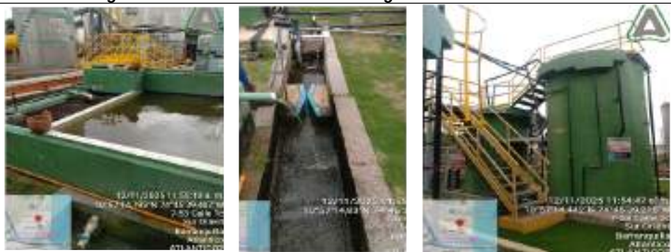
Fotografía 8. Planta de tratamiento de aguas residuales domésticas
