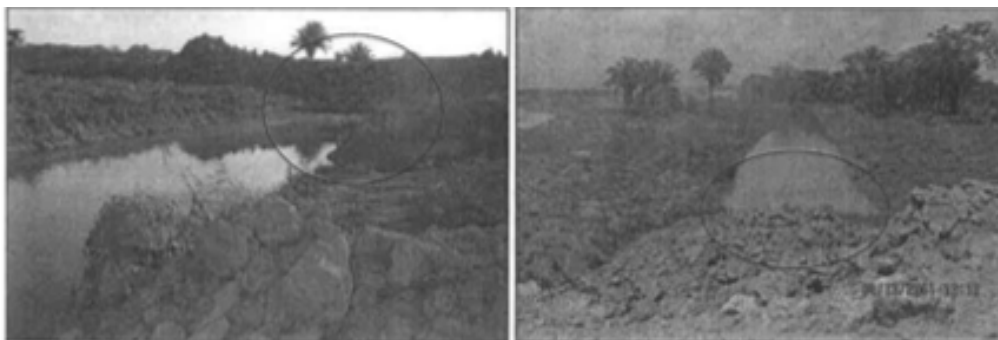
Fotografía 3 y Fotografía 4 :Se observa el punto del taponamiento del caño Caimancito
