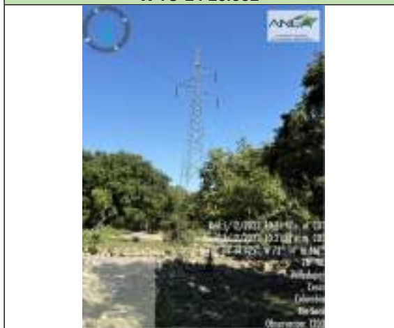
Fotografía 30 Señalización Torre 97. Coordenadas Geográficas: N 10° 34' 14.425"; W 73°14'16.661"
