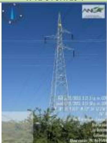
Fotografía 29 Señalización Torre 208. Coordenadas Geográficas: N 10° 55' 9.155"; W 72°54'57.716".
