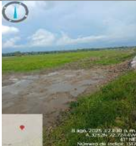
Fotografía. Línea de flujo Bolero - Kitaro OUN E:5030659,34 N:2036576,98
