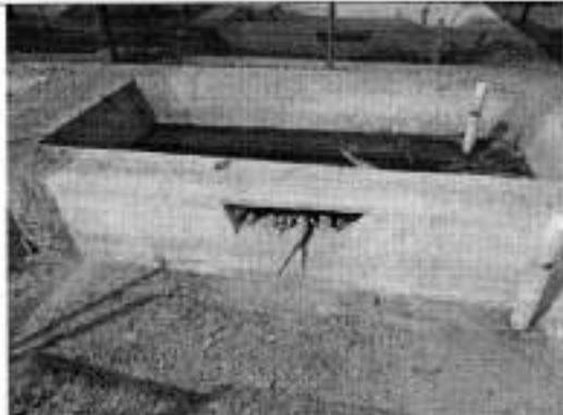
Pileta con un nivel de agua bajo en uno de sus estanques
