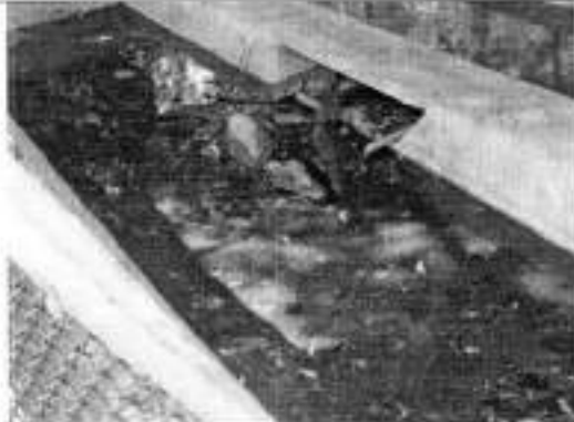
Pileta con alto contenido de material sólido
