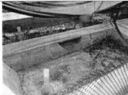
Pileta desocupada sin agua y con material vegetal en su interior
