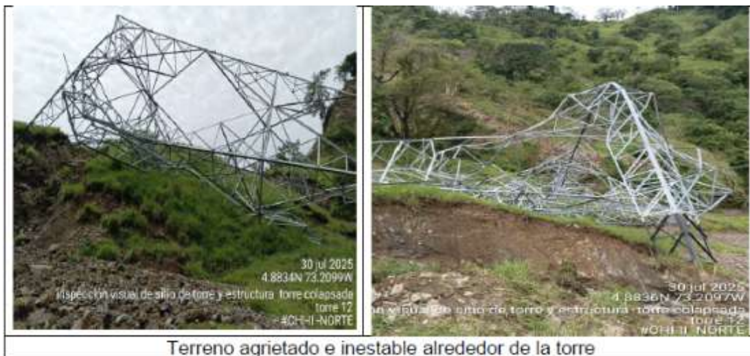
Terreno agrietado e inestable alrededor de la torre
