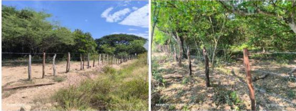
Figura 1. Captura de pantalla – Cerca perimetral instalado año 2024.
